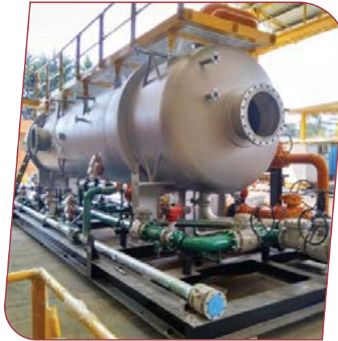
Separadores trifásicos (para crudo)
