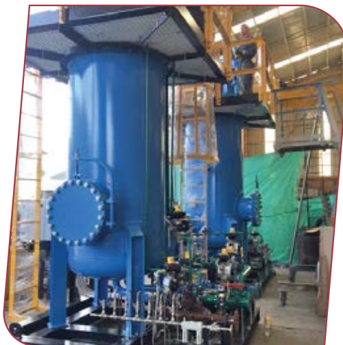
Filtros de lecho vegetal
